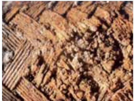
Bild 2: Beschädigte Stelle, Äußerung abgetrennt. Starke Zerstörung der äußeren und zum Teil der inneren Drahtgeflechtlage.
